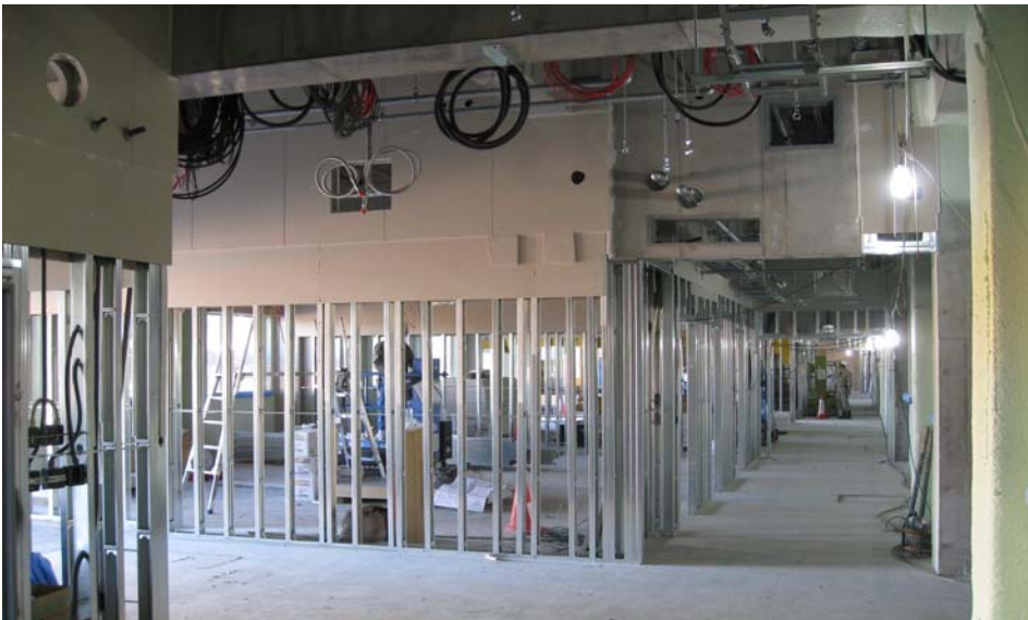
2月22日管理棟1階部分防火区画・主要壁間仕切施工状況です。
