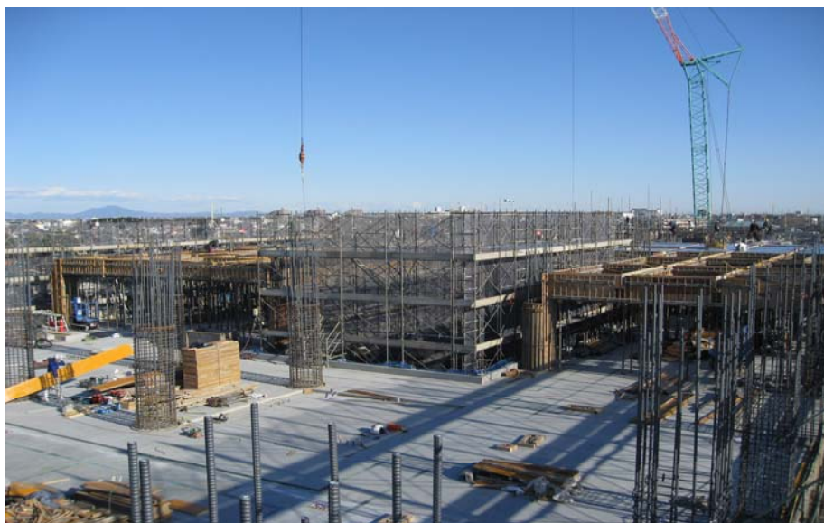
12月21日病棟部分4階部分立上り柱配筋・型枠建込み状況です。
